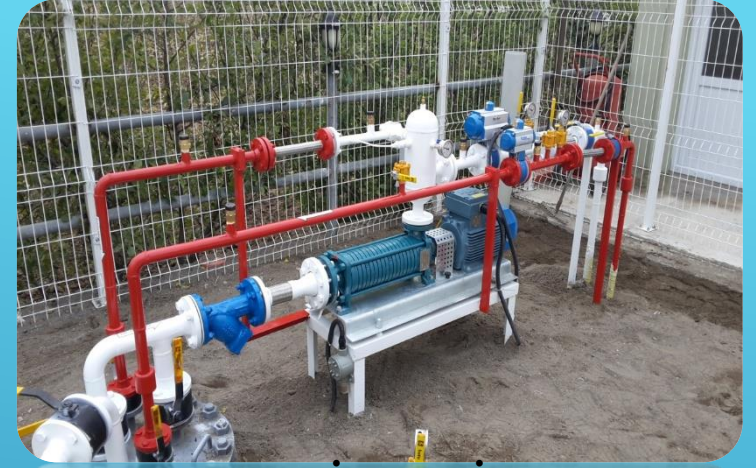
LPG - CNG İkmal İstasyonu
